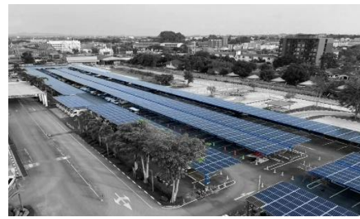
โครงการ BDMS ติดตั้ง Solar Roof 1,000 kWp
