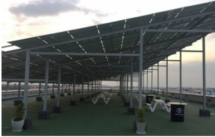
Solar Rooftop 4,999 kWp หลังคาพลังงานแสงอาทิตย์เพื่อการ พักผ่อนหย่อนใจในอาคารสำนักงาน จ.สมุทรสาคร
