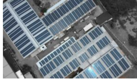
Solar Rooftop 800 kWp บนหลังคากระโจม (Cascade roof) ของโรงงานอุตสาหกรรม จ.พระนครศรีอยุธยา
