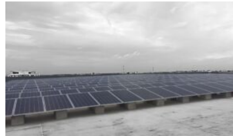
Solar Rooftop 240 kWp บนหลังคาคอนกรีต ของอาคารศูนย์ข้อมูล จ.ชลบุรี
